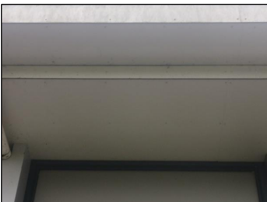
Figuur 2.14: Op enkele uitzonderingen na, zijn de meeste panelen van de overhangende dakgoot nog in goede staat.
