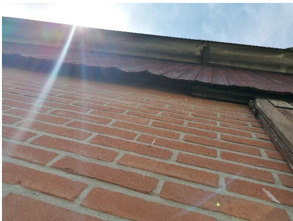
De ruimtes tussen de gevel en de houtbetimmering zijn te ruim voor vleermuizen om een verblijfplaats achter te bezetten.
